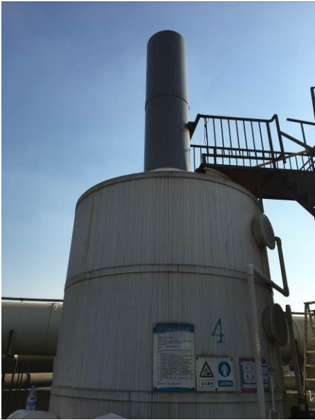
项目 3#碱液喷淋装置
