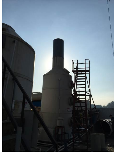
项目 4#碱液喷淋装置
