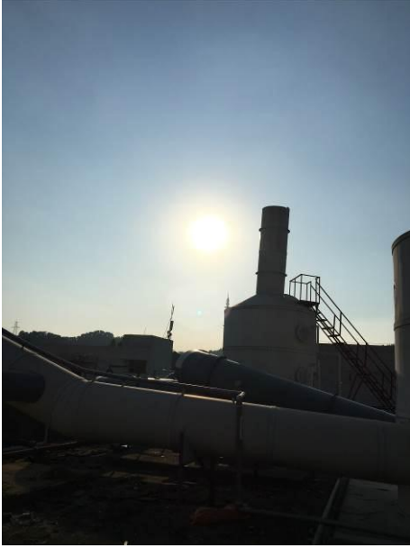
项目8#碱液喷淋装置
