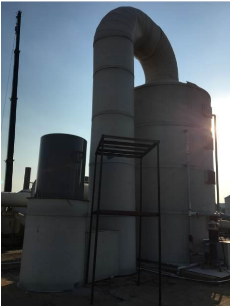
项目 6#碱液喷淋装置
