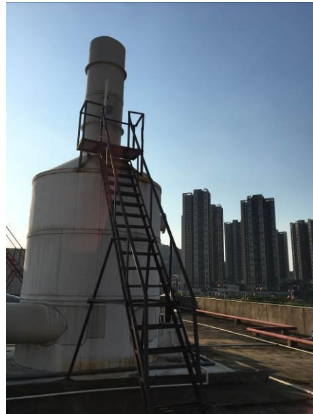
项目 7#碱液喷淋装置
