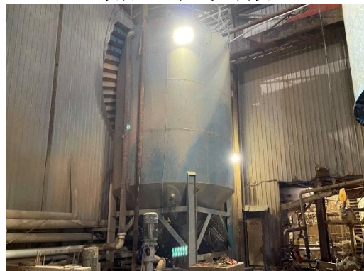
废水处理系统
