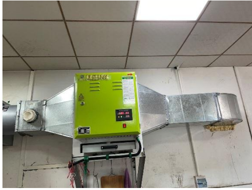
油烟净化装置及采样口
