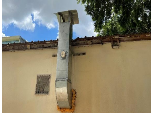
油烟净化装置排放口
