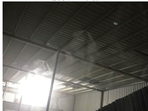
车间喷淋系统
