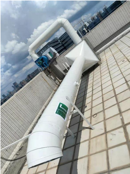
项目活性炭吸附装置及排放口
