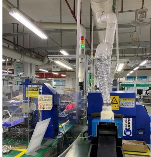
车间废气收集管道
