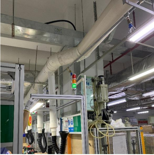
车间集气罩及收集管道
