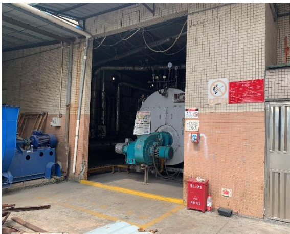
6t/h“低氮燃烧”燃气锅炉
