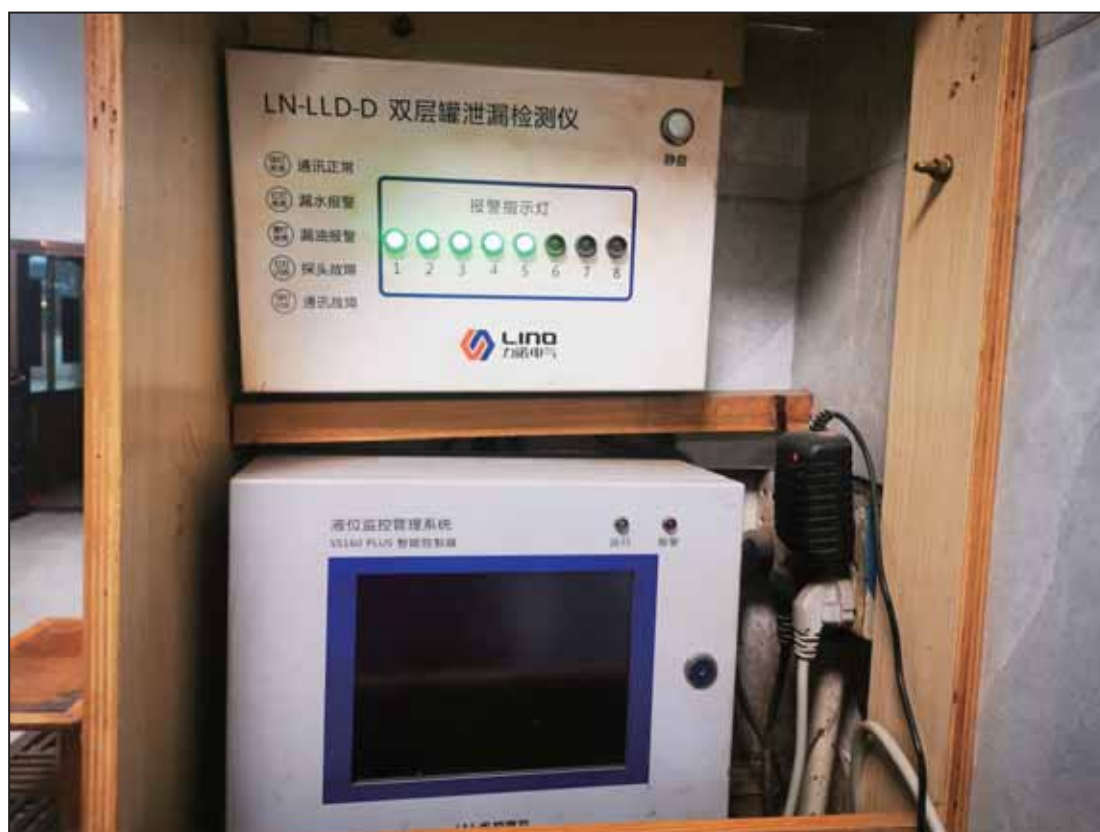
图 3.4-2 圆墩吉星加油站双层罐泄漏检测仪
