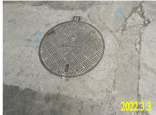
项目车间外污水井
