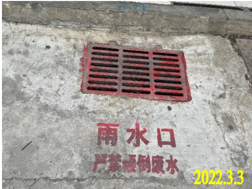
项目车间外雨水井
