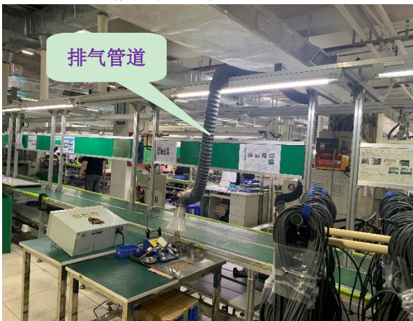
焊锡废气收集工位
