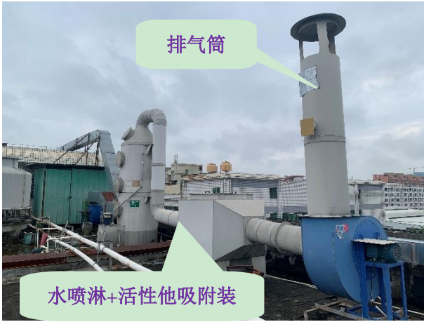
废气治理设施
