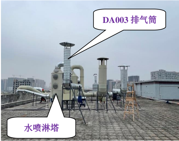
废气处理设施
