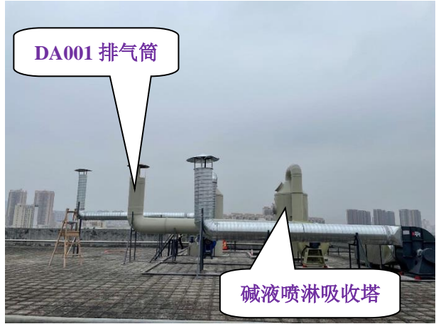
废气处理设施
