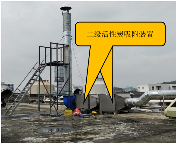
废气处理设施
