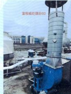
G2 工业废气处理后检测口
