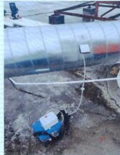
G1 工业废气处理前检测口
