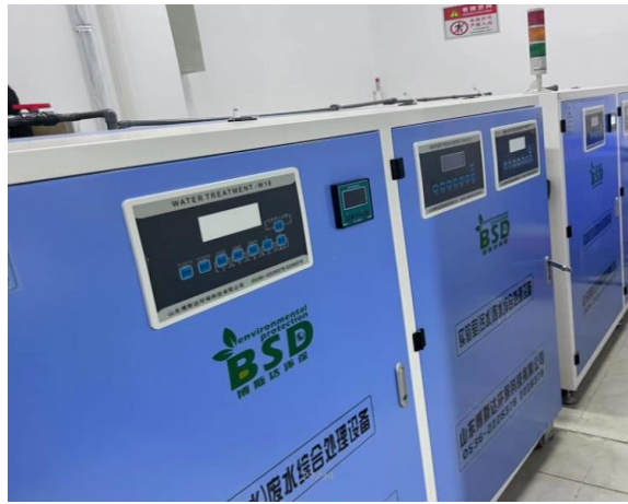
废水处理设施
