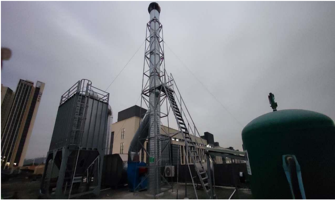
废气处理设施：“脉冲袋式除尘器+活性炭装置”
