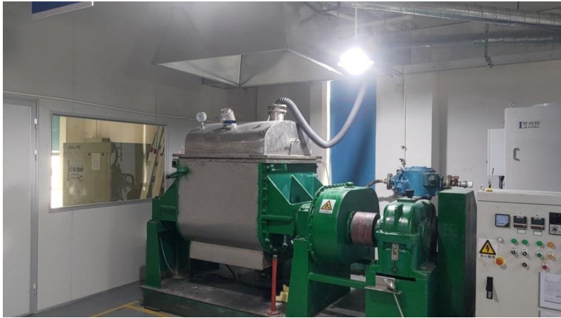
捏合机设备集气管道
