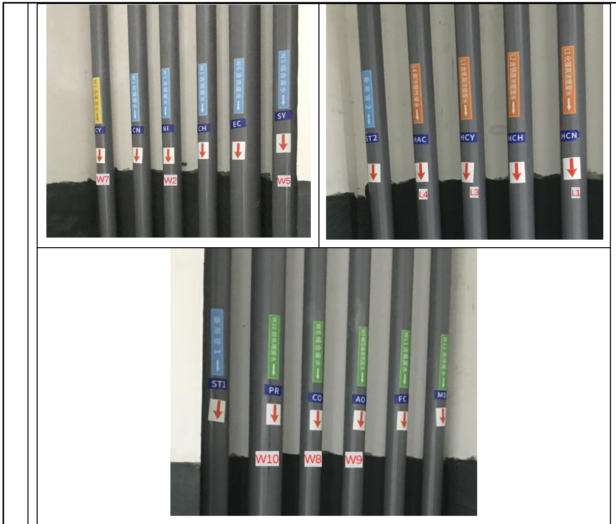
图 4-1 本项目所在 1#厂房一层废水收集管道
